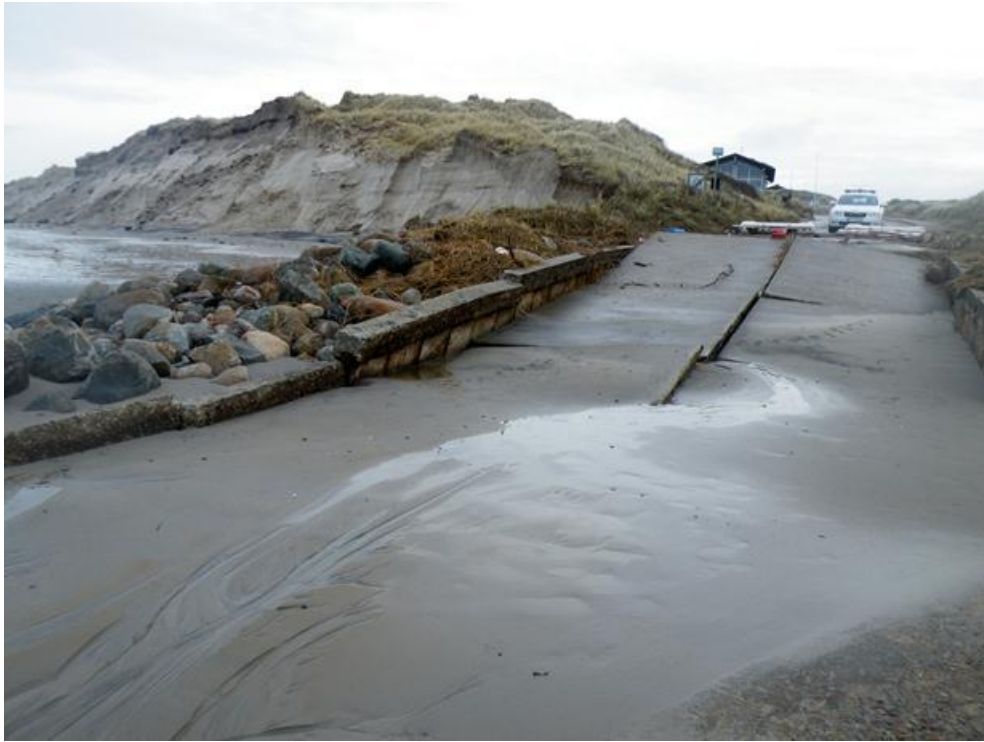
Vejen har nu været afspærret siden d. 9 december 2011.
