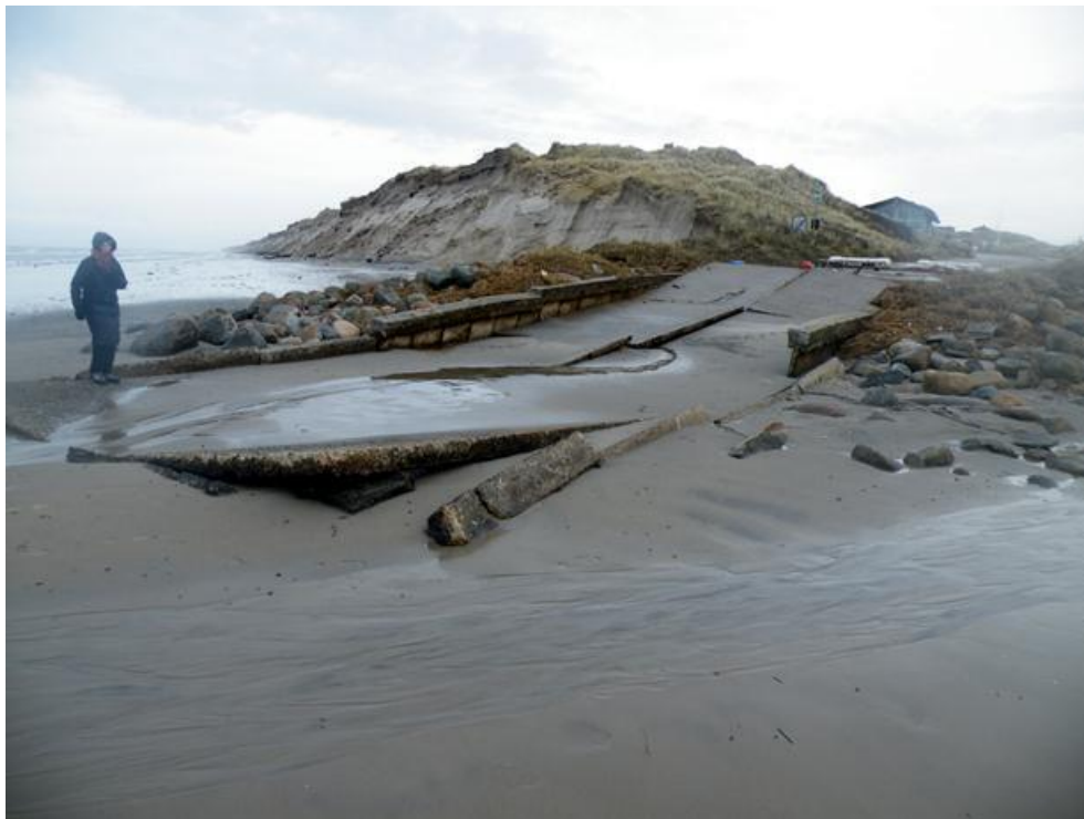
Nedkørslen ved Kandestederne er total kollapset
